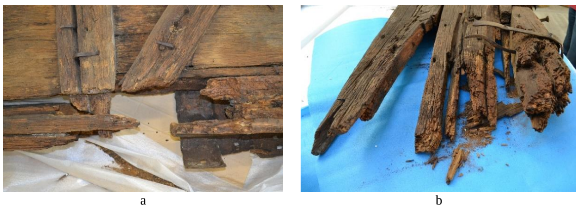
Fig. 3. Detalii ale degradărilor suferite de elementele de lemn și metal ale porților.
