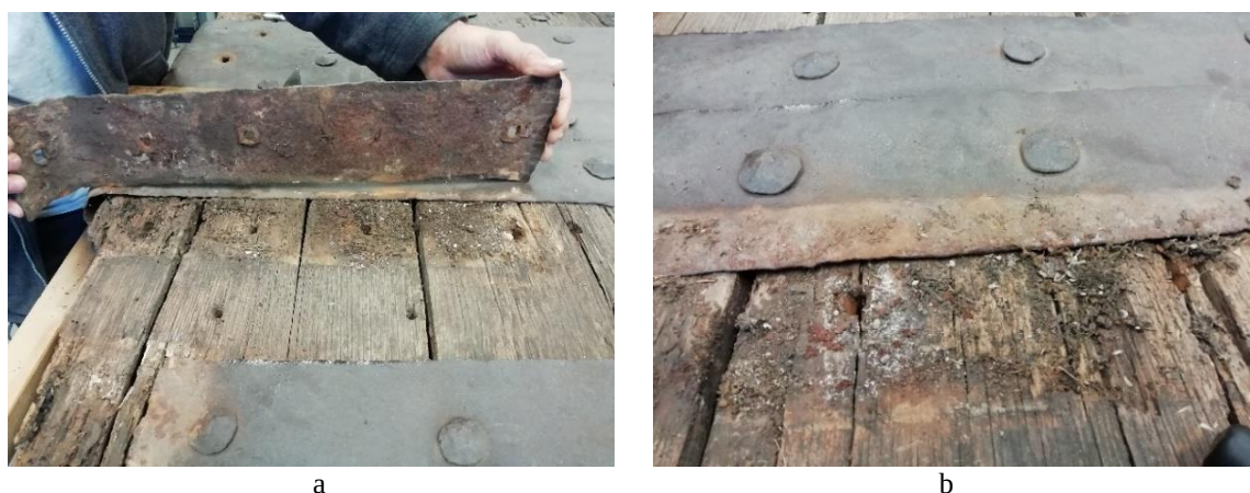
Fig. 4. Starea de conservare a elementelor de lemn și metal în timpul demontării.
